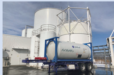
メタン発酵設備（大樹工場）
