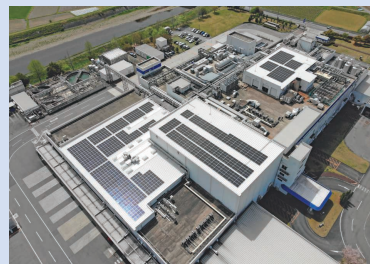
太陽光発電設備（京都工場）
