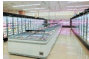
省エネ対応の冷凍ケース
