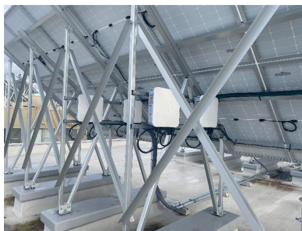
(文化ホールのパワーコンディショナ)
