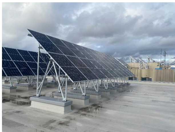
(文化ホールの太陽光パネル)
