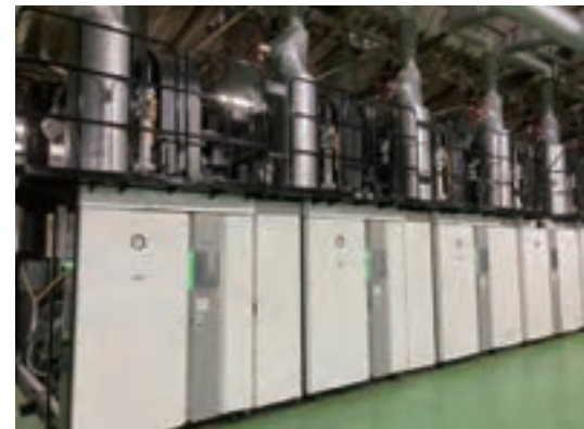
ボイラ設備(大樹工場)
