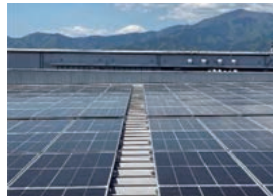
太陽光発電設備(海老名工場)
