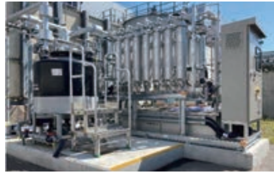
ろ過逆洗水回収設備 (海老名工場)
