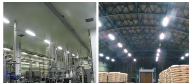
LED照明(阿見工場)
