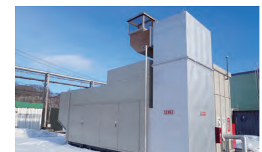
非常用発電機(磯分内工場)
