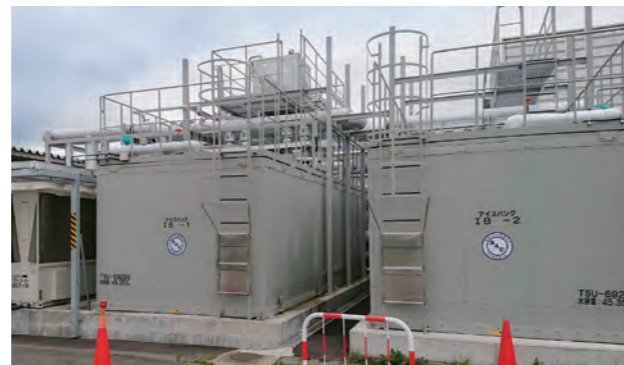
冷却設備(みちのくミルク)
