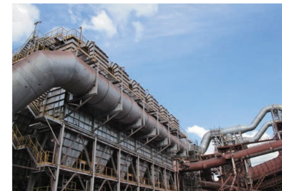
名古屋製鉄所に新設した集じん装置
