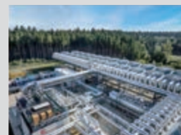
地熱発電 (有機ランキンサイクル発電プラント)
