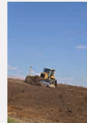
3DMCや3DMGを使った情報化施工 Digital Construction Using 3DMC and 3DMG
