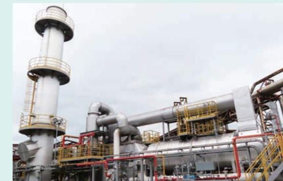
東日本製鉄所君津地区の排ガス燃焼炉
