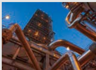
CO 2 回収プラント
